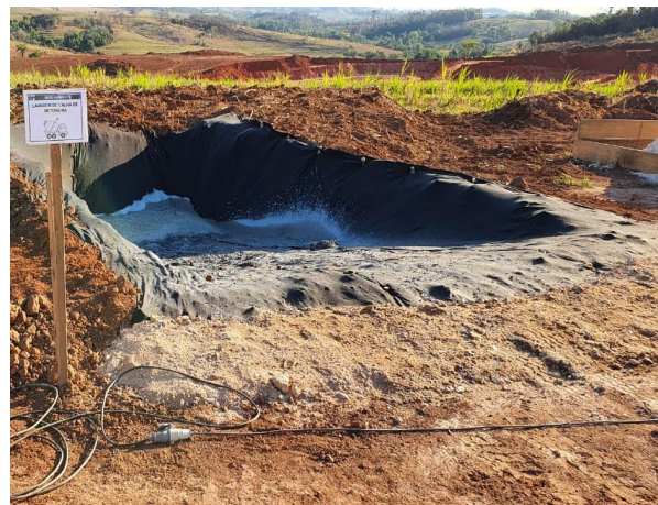
Foto 8: Estruturas no Canteiro administrativo (lavador de bicas, com manta geotêxtil) (24/09/2020)
